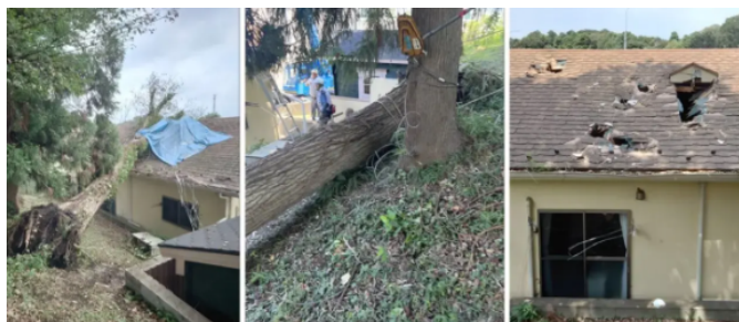
▲被災した施設の様子
